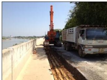
ถ่ายเมื่อวันที่ : 11 พฤษภาคม 2555 09:47:20 น. คำอธิบาย : ขนส่งการขุดร่องเพื่อตอกเหล็ก SHEET PILE
